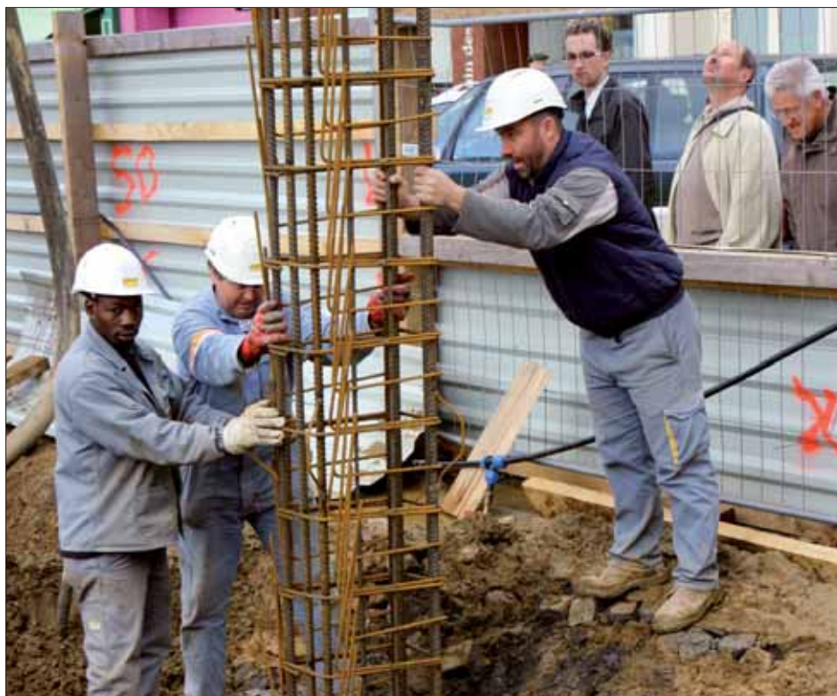
Une ouverture pratiquée dans la palissade permet au public de suivre l'évolution du chantier. Ici, le forage des pieux destinés à soutenir les murs du futur parking souterrain.
